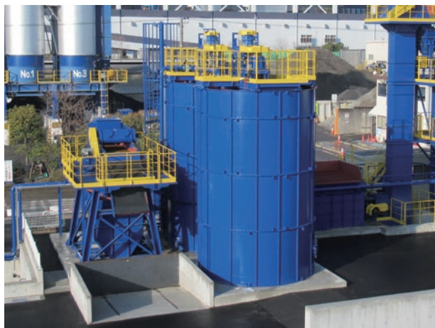
振動ふるい 泥水槽 100m 3 ×2 基
