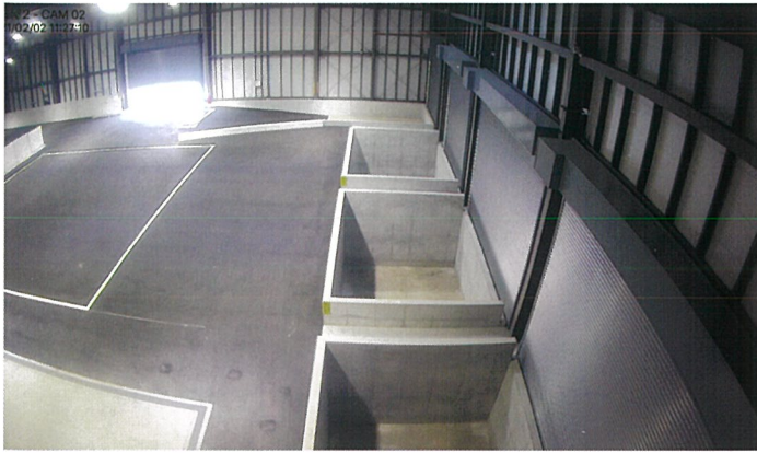
受入・処理ヤード(汚染土壌)、受入ピット×3(汚泥)
