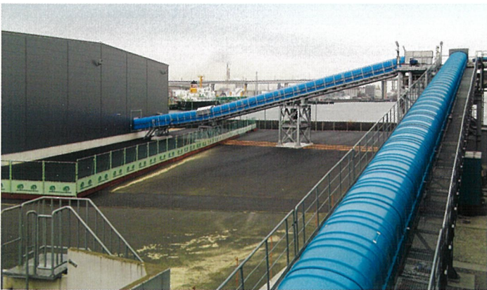
飛散防止カバー付ベルトコンベア(搬送能力: 300 m 3 /h)
